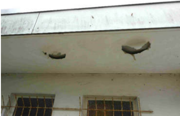
Foto 33: Dachabschlüsse bzw. Bleche liegen dicht an; dünne Farbschicht blättert ab
