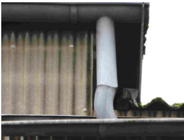
Foto 47: nicht vollständig einsehbare Nische am Höhenversprung des Daches
